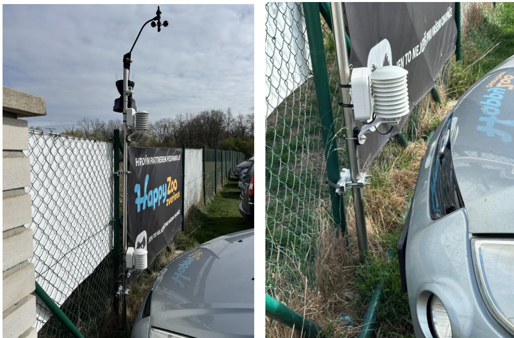
Obr. 23 Uhřetěves (Pesopark) – vlevo nevhodné umístění teplotního čidla a vhodné umístění srážkoměru a anemometru; vpravo detail problematického umístění radiačního krytu v prostoru parkoviště, kde měření ovlivňují těsně parkující vozidla (snímek z 5. 4. 2024).
