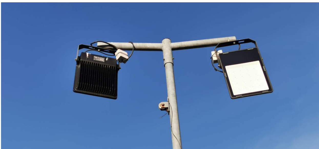
Obrázek č. 5 – Detail původního a nového svítidla u skateparku
